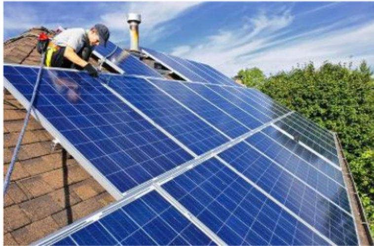
Sempre più richiesti gli impianti a energia solare
